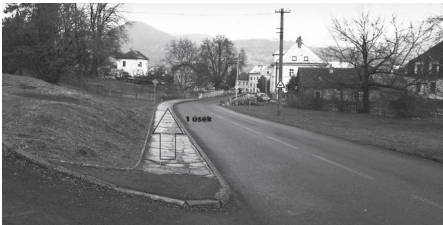
Chodník v ulici Litoměřická před rekonstrukcí.
